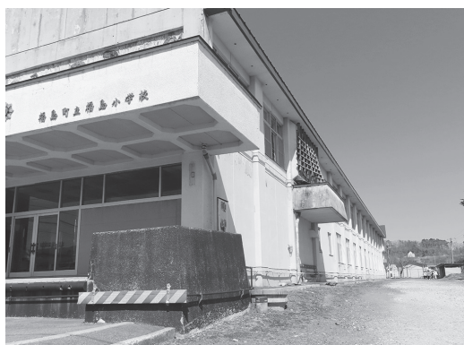
福島小学校南側校舎外壁補修工事 400万円 ほか9事業を追加
